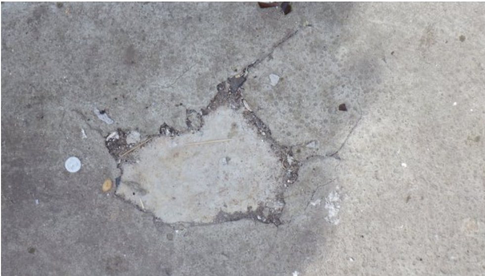
Defekte Abdichtung in der Brunnenschale, Rissbildung.
