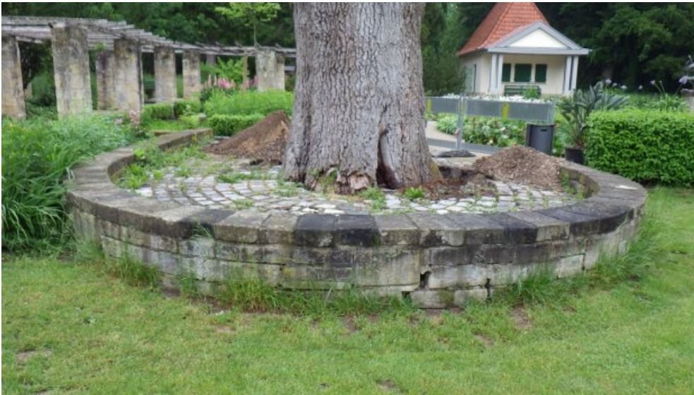
Die Einfassungsmauer wies durch aufgrund des Wachstums des Baumes entstandenen Druck Schäden auf.
