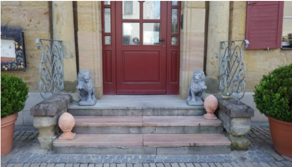
Die Treppenanlage am Eingang zum Gasthof in der Herrengasse 5 in Eckental (Eschenau) vor der Restaurierung.
