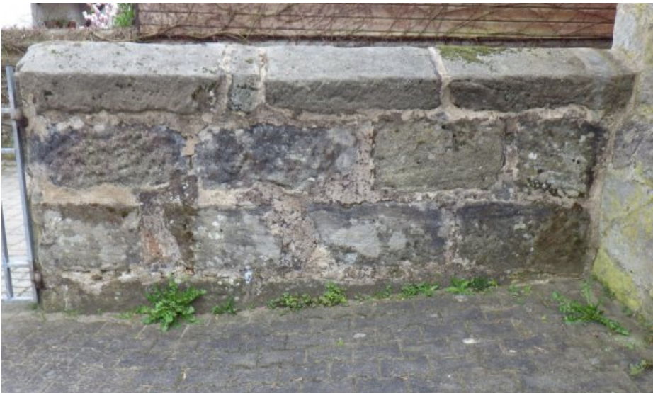
Ein Mauerabschnitt der Friedhofsmauer am Kirchweg vor der Restaurierung. Fehlstellen im Mauerwerk waren mit Fugenmörtel geschlossen worden.
